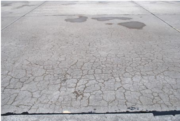
Rys. 1. Siatka spękań na powierzchni płyty lotniskowej
