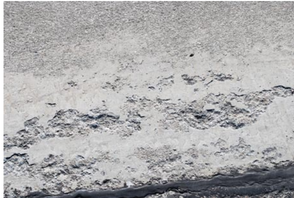
Rys. 2. Złuszczenie głębokie w warstwie przypowierzchniowej nawierzchni lotniskowej
